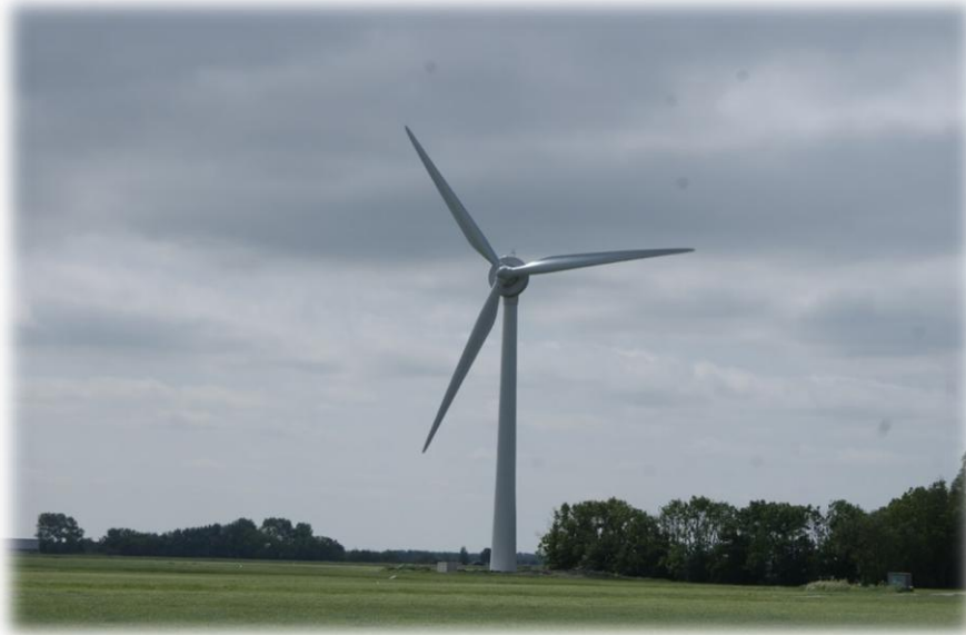
Rys. 26. Elektrownia wiatrowa Autor: Ryszard Wnuk
